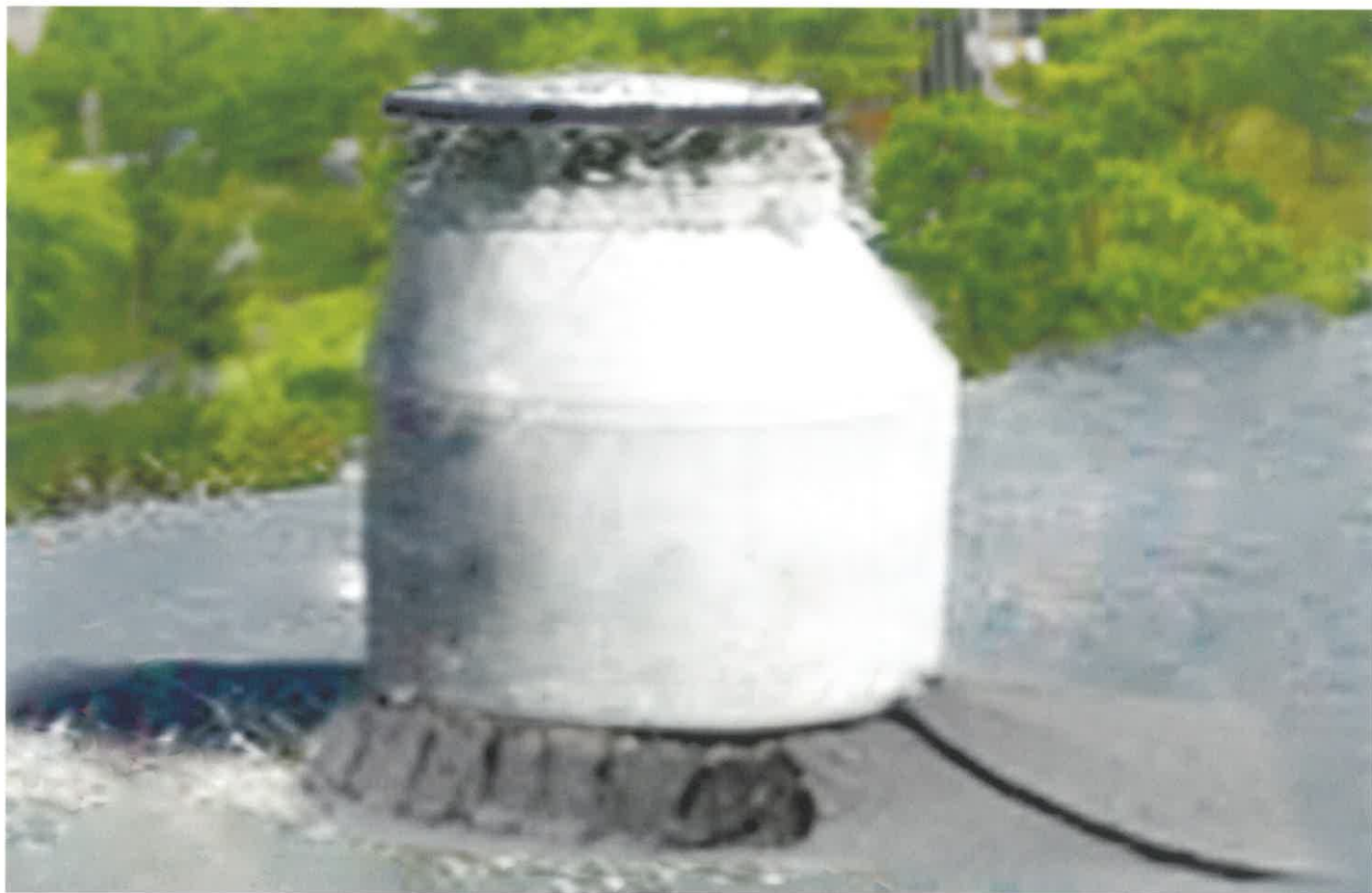
マンホール液状化による被害実例
