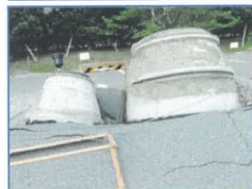
貯水槽マンホールの突出
